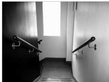
Slika 21. Rukohvati na stepeništu postavljeni zbog sprječavanja padova.
